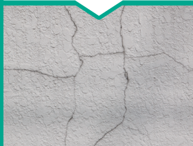
〈外壁〉ヒビ割れ
