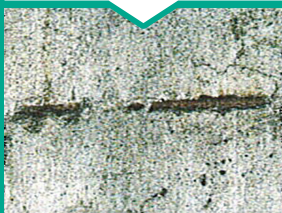
〈外壁〉鉄筋露出
